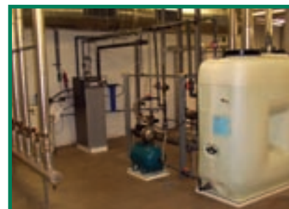
Reversed Osmose installatie
