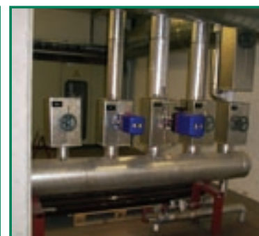
Automatische afsluiters op de stoomleidingen naar de gebruikers
